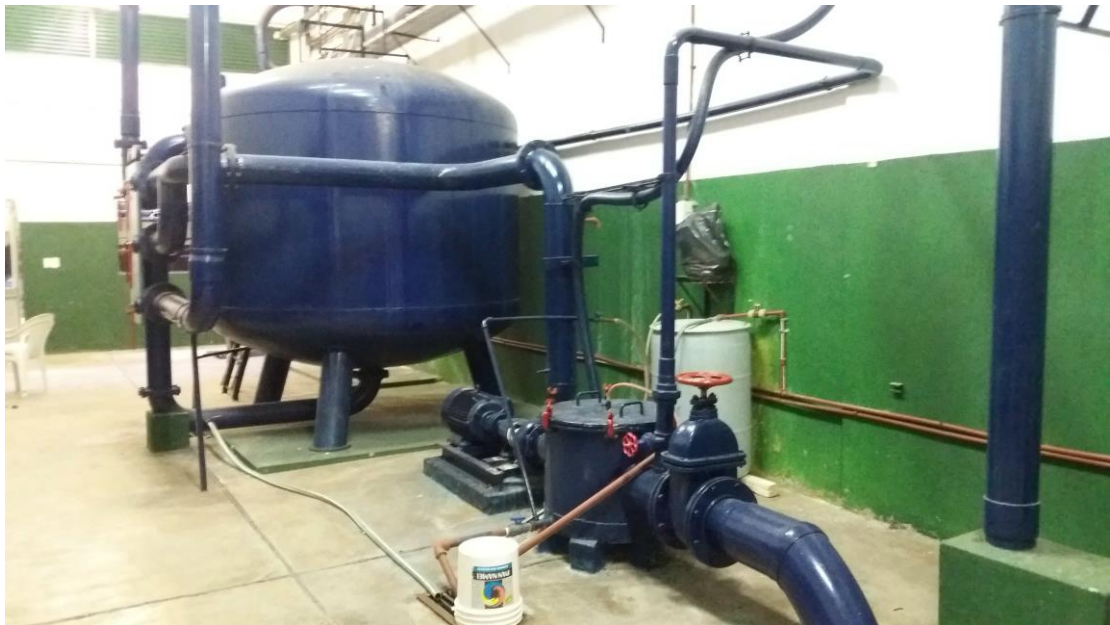
FILTROS DE PILETA DE SALTOS
